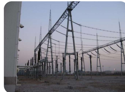
Гибкая ошиновка подстанций
